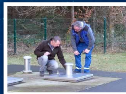
Wassermeister Frank Heckmann und Obermonteur Martin Lindenau bei der Brunneninspektion am Brunnenstandort der Wasserförderung in Friedrichsgabe.
