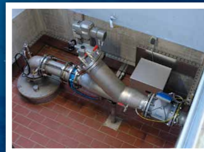
Die geförderten Mengen Wasser werden mit Hilfe der Wasserzählung am Brunnenkopf genau erfasst.
